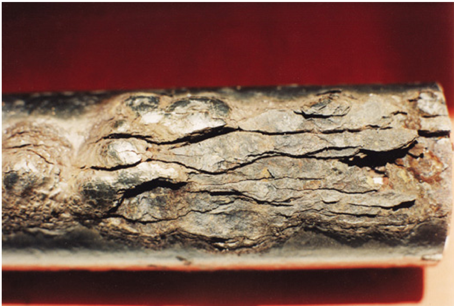
Esfoliação em tubo de aço-carbono.
